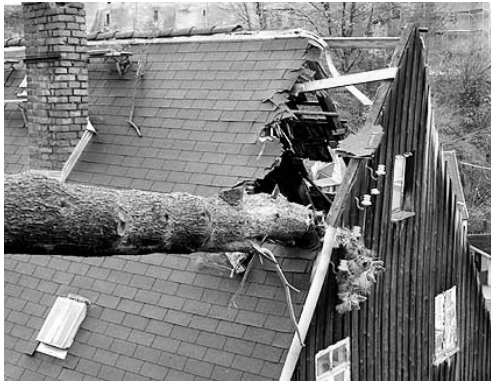
Abbildung 1: Schaden durch einen umgestürzten Baum nach dem Orkan Jeanett am 27.10. 2002 in Zschopau (Erzgebirge).
