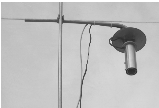
Abbildung 53: Ventilierter Strahlungsschutzhütte mit HUMITTER 50 Y-Fühler, montiert in 3,3 m Höhe innerhalb SAPHIR.
